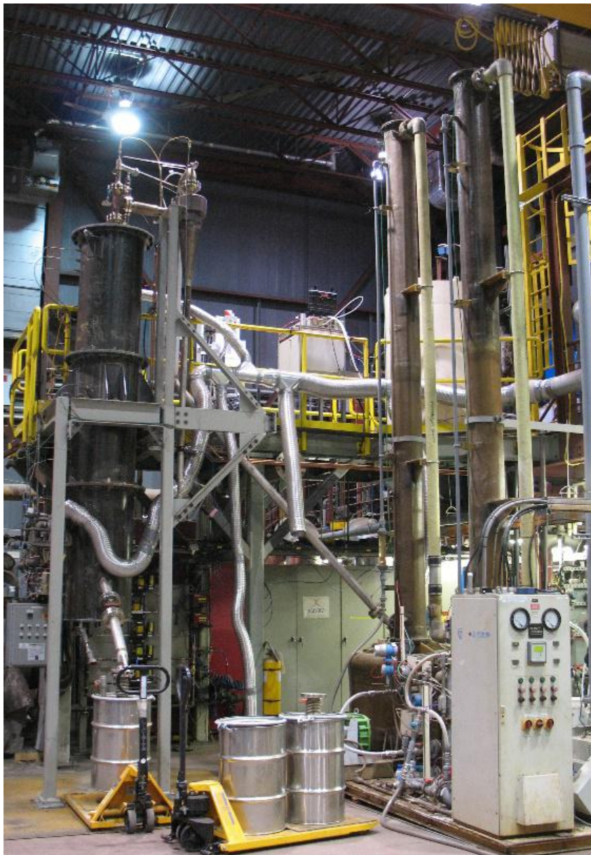
Figure 13-29 : Four de grillage de 12 po
